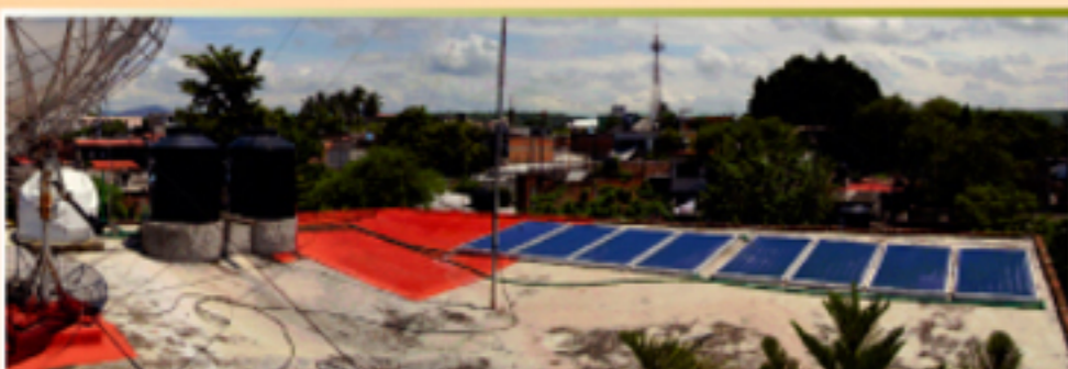
Equipo de calentamiento solar de agua instalado en la azotea de las oficinas de pollos "Virgo"
